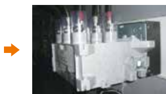
取替後のVCB
