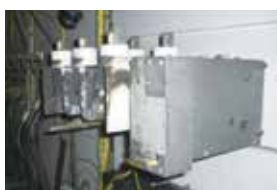
焼損したVCB
