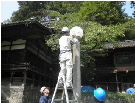
丸子地区神社の設備点検
