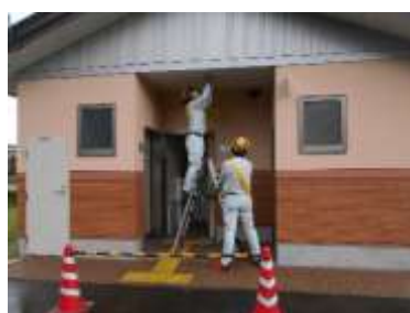
公園施設の設備点検
