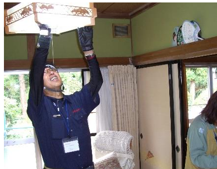
高齢者住宅の照明器具点検
