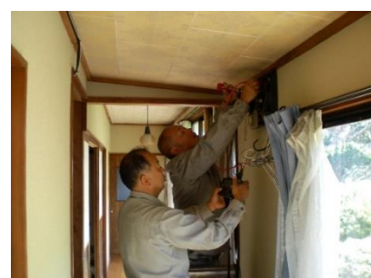
高齢者住宅の絶縁測定
